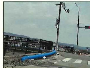
地上を這う水道管(青い管) '25.3 輪島市
