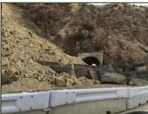
山崩れでトンネルが不通 '25.3 珠洲市付近
