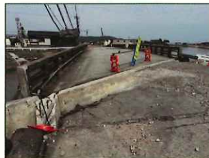
橋と道の継ぎ目に段差 '25.3 珠洲市付近
